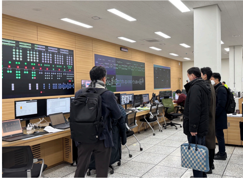
| 수도권광역급행철도 GTX-A 노선(운정중앙역~서울역) 상황실 |
